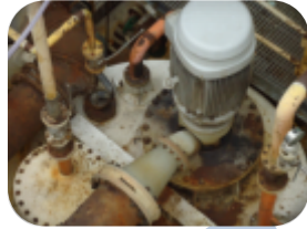
Bombas de Ácido
