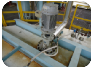
Bombas de Enxofre
