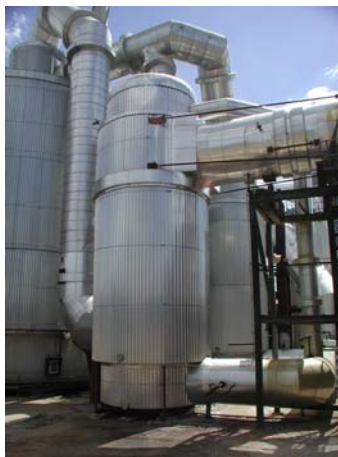
Trocador gás / gás na Sasol Agri., Julho de 2002 durante a fase 2 da reforma da planta de ácido
