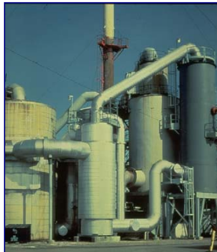
Trocador gás / gás em aço inox instalado em 1982, como parte de uma reforma de fábrica para Dupla Absorção
